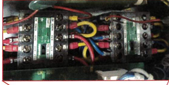
写真3 ブレーキ回路内電磁接触器
